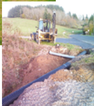
Réseau pluvial descente de la Jonière
