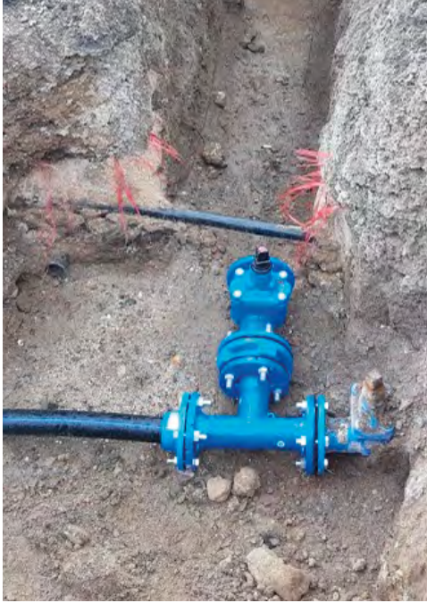
Conduite d'eau à Lomanie
